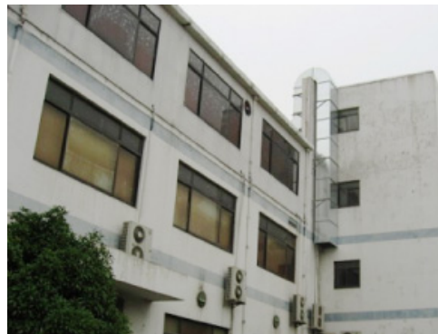
UV塗装工程排気ダクト
