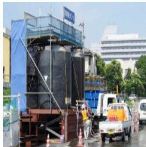
アメニクリーン貯留タンク
