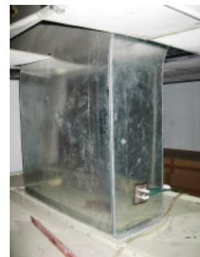
エアーケム噴霧ノズル設置
