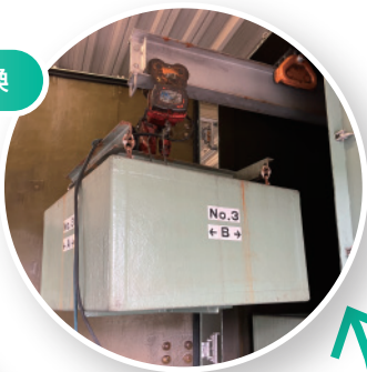
カートリッジ交換
