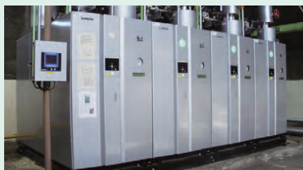
ガスボイラー
