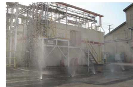
四日市事業所 水幕設備
